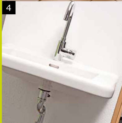
4 Waschbecken „Vitalis“ (rund) oder „Dejuna“ (eckig) von Keramag in Weiß mit Flachsiphon; für Rollstuhlfahrer unterfahrbar; Einhand-Waschtisch-armatur von Grohe mit hohem Auslauf
