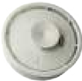
Dieser Rauchmelder wird von der SWB ferngewartet.
