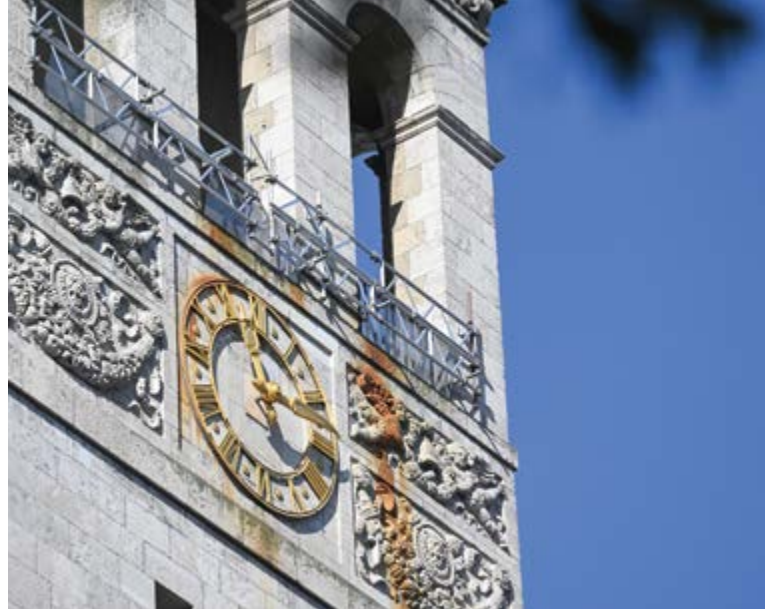
Die Feuchtigkeit mit den Rostrückständen schädigte auch die Fassade.
